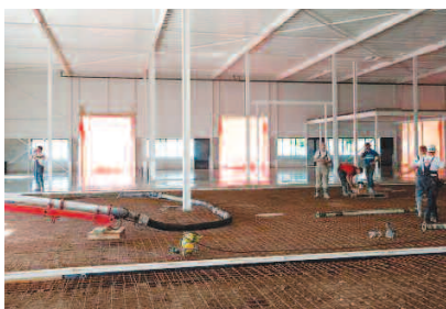
Fot. 2. Układanie wodoszczelnej posadzki na palach; zbrojenie Dramix® 4D 65/60BG w ilości 30 kg/m 3 i siatka stalowa ø8, 150 x 150 mm na całej powierzchni, beton C28/35, grubość 180 mm
