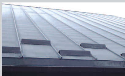
Fot. 1. Stalowe panele zatraskowe ułożone na łąkach, które są wyraźnie widoczne. Ugięcia między łąkami powstają m.in. z powodu zablokowania ruchów termicznych przez wadliwie zamocowane płotki przeciwśniegowe
