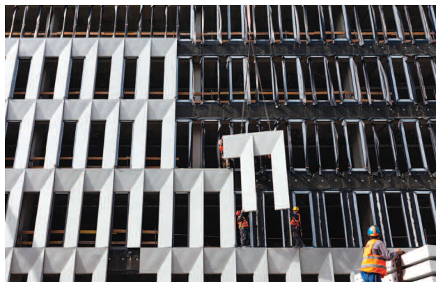
Fot. 4. Retro Office House we Wrocławiu – montaż prefabrykowanych elementów elewacji wyprodukowanych przez firmę Betard
