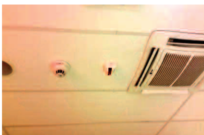
Fot. 1. Wskaźnik zadziałania czujki umieszczonej w przestrzeni międzysufitowej
