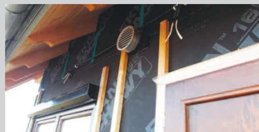
Fot. 2. Otwory w ścianach, w których poprowadzono kable, zmniejszające szczelność powietrzną
