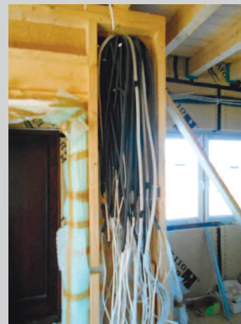
Fot. 3. Duża liczba przewodów przechodzących z wnętrza obiektu na zewnątrz, co utrudnia uzyskanie szczelności na przewiew
