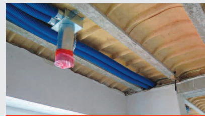
Fot. 5. Przewody wentylacji mechanicznej
