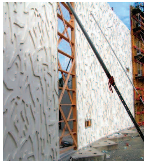
Fot. 3. Atrakcyjne wykończenie powierzchni betonowej uzyskano dzięki zastosowaniu mieszanki betonowej z domieszką MasterEase, która ma małą lepkość [2] i perfekcyjnie wypełnia deskowanie
