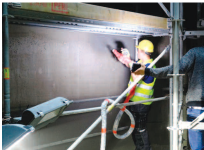
Fot. 3. Aplikacja powłoki hydroizolacyjnej (pod ciśnieniem) na ścianie tuby, po potwierdzonym braku zagrożenia powstawaniem kondensatu – efekt użycia nagrzewnic i kierunkowego nadmuchu
