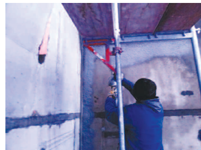
Fot. 1. Aplikacja ciśnieniowa hydroizolacji ATLAS Woder Duo na odpowiednio przygotowane podłoże betonowe
