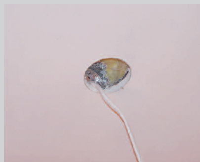
Fot. 1. Wadliwe zamocowanie metalizowanego opóźniacza pary. Folia została przedziurawiona i styka się z płytą gipsowo-kartonową, co uniemożliwia jej prawidłowe uszczelnienie z murem (jest na to za mało miejsca)
