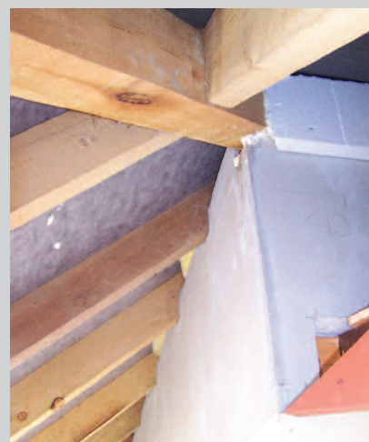
Fot. 2. Drugim miejscem najczęstszego powstawania przewiewów są murlaty. Pod membraną, nawet po zamontowaniu podbitki, liczne szczeliny umożliwiają ich powstawanie. Podobnie jest wokół lukarn i wszelkich innych połączeń drewno – mur
