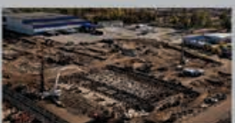
Obiekty instalacyjno-magazynowe w ramach inwestycji dla Stora Enso w Ostrołęce
