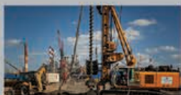
Instalacje wchodzące w skład EFRA PROJECT i EFRA PROJECT HVDU na terenie rafinerii LOTOS w Gdańsku
