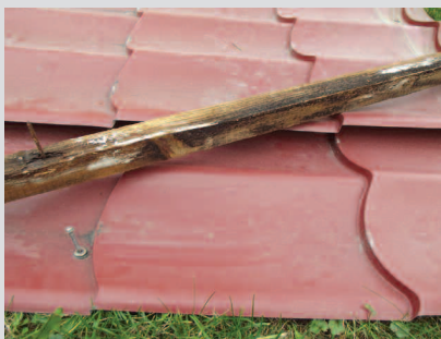
Fot. 3. Przedostatnia łąta zdjęta z powodu bardzo złego stanu. Jest spróchniała i zagrzybiona lub spleśniała. Podobnie było z wszystkimi wymienionymi łątami (3 rzędy pod kalenicą), których stan był tym lepszy, im niżej się znajdowały
