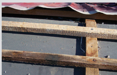
Fot. 1. Dach budynku wielorodzinnego w trakcie odkrywki wykonanej w celu wydania opinii dotyczącej jego stanu technicznego. Dach ma 3,5 roku i wiele problemów. W tym miejscu przedostatnia łąta już gnije
