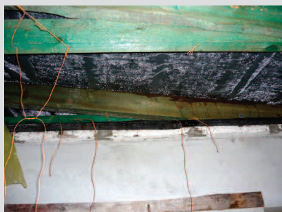
Fot. 1. Poddasze, w którym stwierdzono zacieki na paroizolacji i ścianach po zdjęciu paroizolacji i termoizolacji. Na MWK zamrożona skroplina, na krokwiach zacieki znamionujące dłuższe podciekanie wzdłuż kontrłaty. Efekt braku wylotów (fotografia 2) i wlotów (fotografia 3) ze szczeliny utworzonej przez kontrłatę
