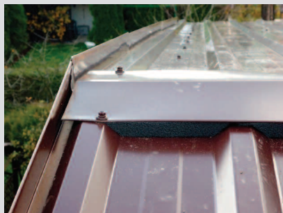
Fot. 2. Dach z fotografii 1 tuż po wykonaniu. Uszczelka zamyka bardzo skutecznie wylot z przestrzeni, która powinna być wentylacyjna. Ten szczegół i brak odpowiedniego wlotu w okapie zablokowały odpływ pary wodnej z termoizolacji i wilgoci technologicznej z poddasza
