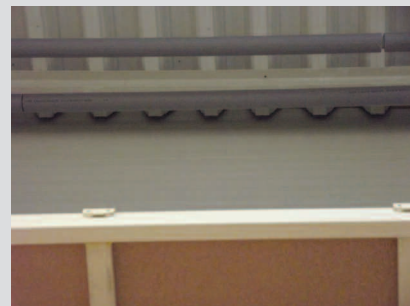
Fot. 4. W tej hali każdego ranka zbierano kilka wiader wody wyciekającej z zakładów na blasze trapezowej. Połączenia między blachą a ścianami zewnętrznymi, świetlikami i wentylatorami mają szczeliny a paroizolacja z folii PE leży na blasze w luźnych niesklejonych pasmach
