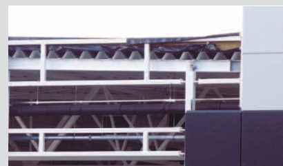
Fot. 5. Hala w budowie. Strop z blachy trapezowej wyraźnie odstaje od konstrukcji ściany, a paroizolacja leży na krawędzi blachy w przypadkowych fałdach. Przy tak prowadzonej budowie uszczelnienie warstwy paroizolacyjnej jest niemożliwe. Tędy dostaje się powietrze i para wodna do wełny mineralnej
