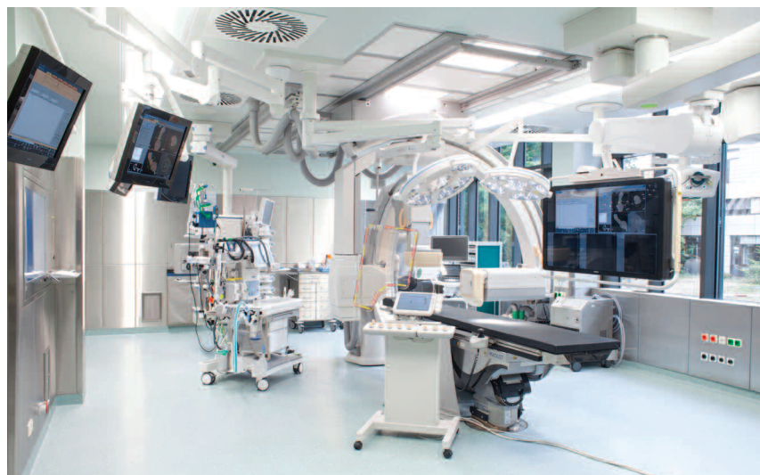
Sala operacyjna w Instytucie Chorób Serca w Berlinie, gdzie zastosowano powłoki ścienna firmy ROHDE KG
