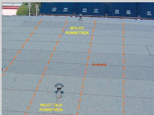
Fot. 2. Dach o konstrukcji drewnianej, z wełną dociśniętą do poszycia z płyt OSB, z kominkami przechodzącymi przez OSB. Jest ich stanowczo za mało, a te na dole mają zbyt mały przekrój. Ten dach miał zacieki zanim został ukończony
