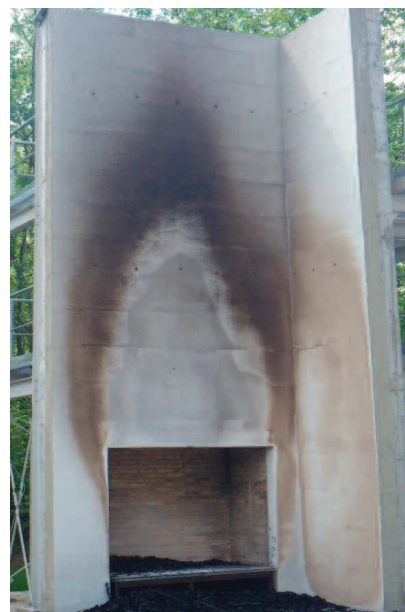
Fot. 1. Widok ściany głównej po badaniu
