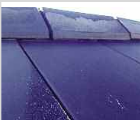
Fot. 4. Wielką pułapką dla niewykształconych dekarzy są modne ostatnio płaskie dachówki. Ich płaskość powoduje, że aby na kalenicach i narożach był wylot wentylacyjny, trzeba unieść gąsior na łacie kalenicowej. Gdy gąsior jest położony na dachówkach, nie ma odpowiedniego wylotu (rysunek 2)
