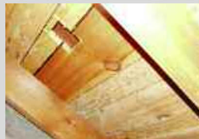
Fot. 2. Na każdej połaci w deskowaniu i papie wycięty jest otwór, który intensyfikuje przepływ powietrza wewnętrznego do niewentylowanej przestrzeni pod dachówką. Takie otwory nie stanowią wentylacji dachu
