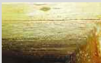
Fot. 1. Pleśń na deskowaniu opisywanego dachu widoczna na strychu (górny dach mansardy), która jest skutkiem zawilgocenia spowodowanego zgromadzeniem skroplin z powietrza wewnętrznego. W dolnej mieszkalnej części mansardowego dachu też można się spodziewać podobnych efektów
