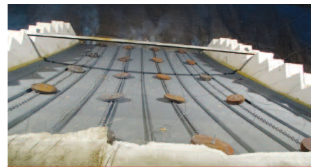
Fot. 1. Ugięcie przekrycia dachowego TYTANIUM PRUSZYŃSKI podczas badania
