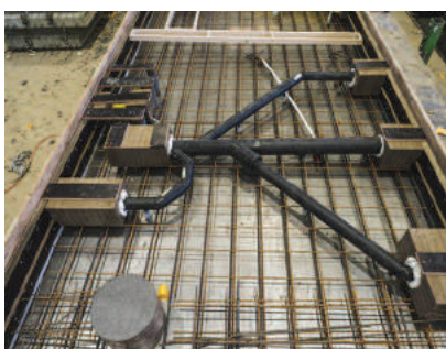
Fot. 4. Elementy sanitarno-ściekowe wewnątrz prefabrykatu
