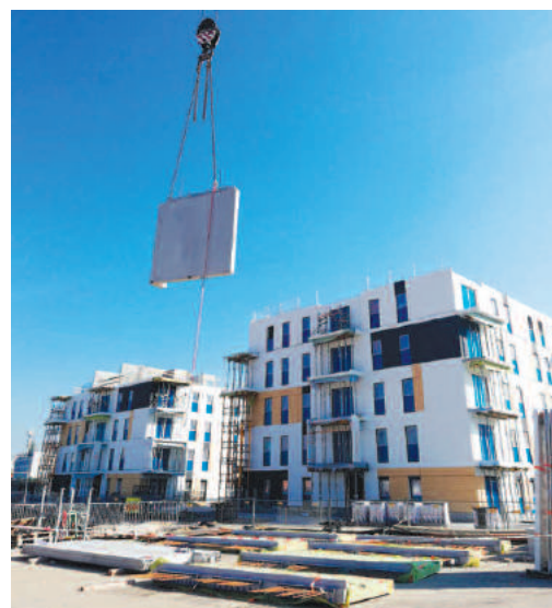
Fot. 5. Osprzęt do podnoszenia prefabrykatów umożliwia ich bezpieczny transport i montaż (Osiedle Ja_Sielska, Poznań)
