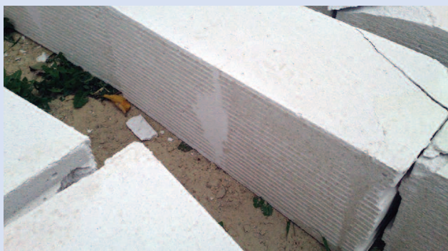
Mimo że mur został uszkodzony, zaprawa wykazuje bardzo dobrą przyczepność do bloczków, co widać na ich powierzchniach wspornych
