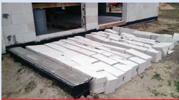
Ściana zniszczona przez wichurę. Pomijając błędy polegające na niezabezpieczeniu wolnostojącego fragmentu ściany, wiele można zaobserwować w kontekście zastosowanej zaprawy
