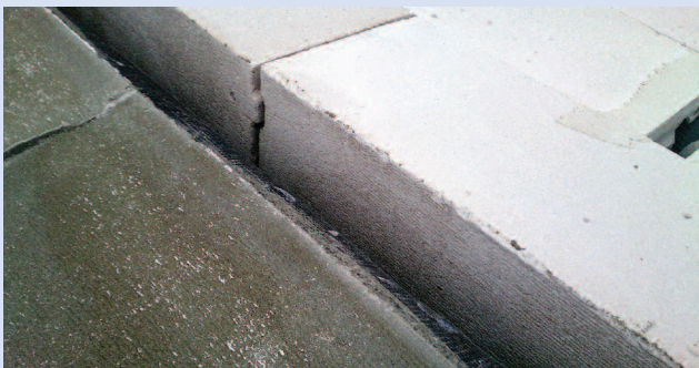
Dolna powierzchnia wsporna bloczków jest czysta i bez śladów zaprawy, a to oznacza, że zaprawa cementowa w pierwszej warstwie nie wykazała właściwej przyczepności do elementów murowych
