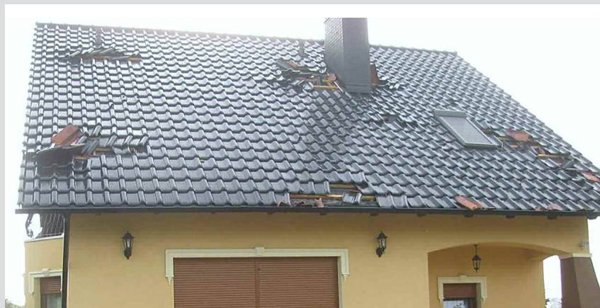
Dach po przejściu huraganu
