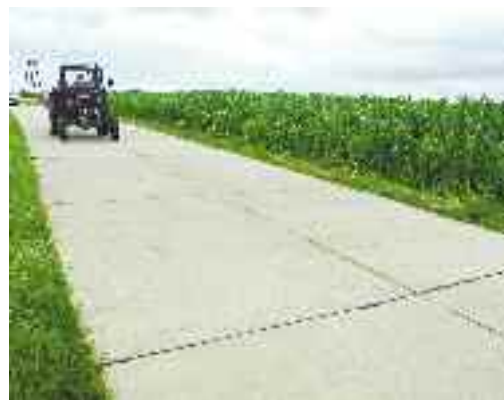
Droga betonowa Przybysławice – Prusy po jedenastu latach eksploatacji
