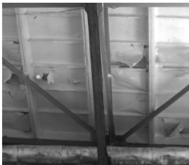
Fot. 4. Uszkodzona powłoka ochronna płyt dachowych [Fot. Autorzy]
