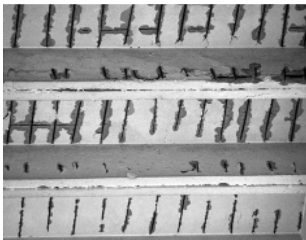
Fot. 2. Skorodowane pręty zbrojenia betonowych płyt dachowych oraz pręty dźwigarów kratowych [Fot. Autorzy]
