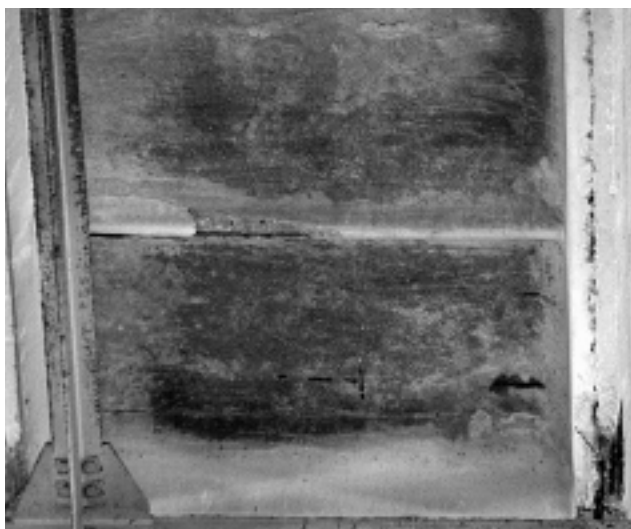
Fot. 3. Uszkodzone betonowe płyty dachowe i skorodowane pręty zbrojeniowe [Fot. Autorzy]
