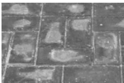
Fot. 3. Wykwity solne
