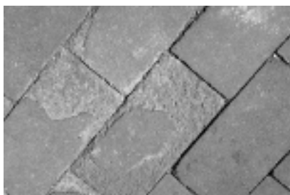
Fot. 4. Destrukcja mrozowa nawierzchni z betonu wibroprasowanego
