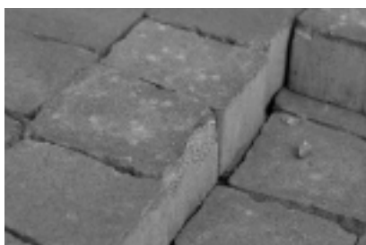
Fot. 5. Uszkodzenie mechaniczne krawędzi elementu
