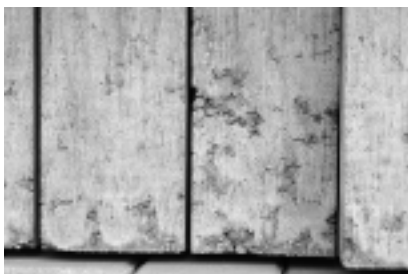
Fot. 7. Niedostatecznie zagęszczony element (krawężnik) z betonu wibroprasowanego
