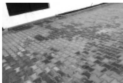
Fot. 8. Zróżnicowana nasiąkliwość kostek z betonu wibroprasowanego
