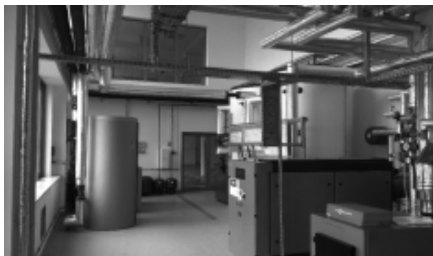
Fot. 2. Fragment węzła ciepłno-chłodniczego w Laboratorium Wytwarzania Energii CBZIE
