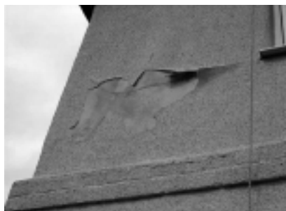
Złuszczenie wyprawy tynkarskiej po 1,5 roku od nałożenia
