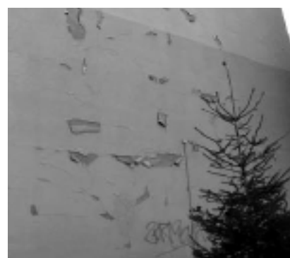
Fot. 1. Odsparzenie wyprawy tynkarskiej
