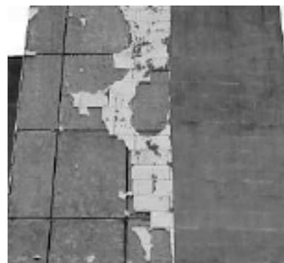
Fot. 2. Zniszczenie elewacji pod wpływem oddziaływania silnego wiatru
