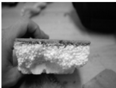
Fot. 5. Przykład pęknięcia powstałego wskutek przyklejenia siatki z włókna szklanego bezpośrednio do styropianu
