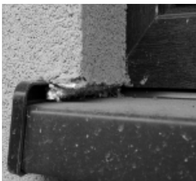
Fot. 2. Nieprawidłowo wykonana obróbka blacharska – niewystarczające zabezpieczenie warstwy zbrojonej przed przedostaniem się wilgoci
