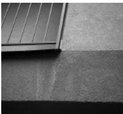
Fot. 3. Nieprawidłowe połączenie płyty balkonowej z ociepleniem, sprzyjające powstawaniu zacieków
