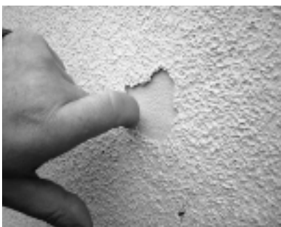
Fot. 1. Awaria związana z brakiem adhezji wyprawy tynkarskiej do warstwy zbrojonej, wskutek prowadzenia prac dociepleniowych przed ukończeniem robót dachowych i wykonaniem obróbek blacharskich
