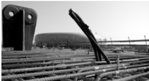
Odpowietrznik kanałów kablowych
