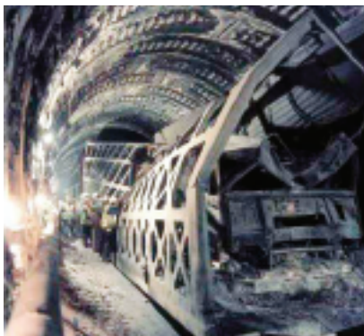
Podczas pożaru w tunelach dochodzi do odpryskiwania betonu
