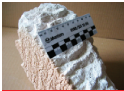
Fot. 1. Wierzchnia warstwa betonu komórkowego po poddaniu obciążeniu ogniowemu w czasie 240 min; widać spękania sięgające jedynie głębokości do 40 mm
