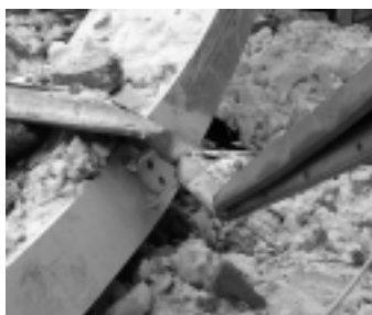
Połączenie belki płatwiowej z dźwigarem blachownicowym (po awarii)
