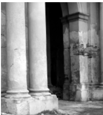
Przykład zawilgoconych i zasolonych murowanych ścian ceglanych
