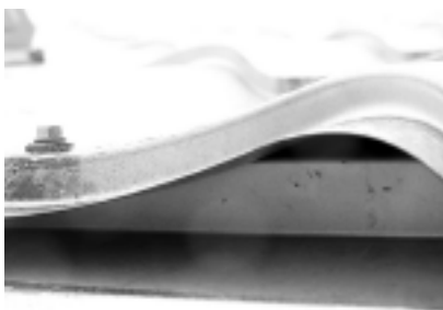
Fot. 8. Widoczny wlot pod fałą profilu jest wielokrotnie za mały, aby powietrze samoistnie popłynęło pod pokryciem (musi mieć jeszcze wylot na kalenicy). Pole powierzchni powinno wynosić minimum 200 cm 2 /m okapu
