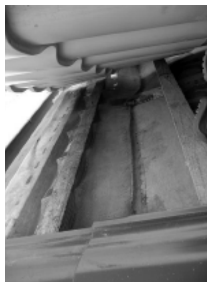
Fot. 11. Zima 2010 r. Lód w kieszeni z wadliwie ułożonej MWK powstał ze skroplin i był przyczyną przecieku. Woda z topniejącego lodu wchodziła w dzień pod zakład między pasmami MWK, a w nocy tam zamarzała
