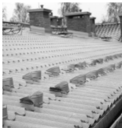
Fot. 9. Ten sam dach jak na fotografii 8. Wiele pokryć z blachodachówki ma za wysokie pasy nadrynnowe (obróbki blacharskie). Tak wykonane służą m.in. zasłonięciu nierówności więzby dachowej
