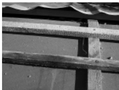
Fot. 15. Dach po czterech latach eksploatacji. Skutki uszczelniania gąsiorów profilowaną pianką. Brak wentylacji pokrycia powoduje, że na ostatnich latach są ogniska korozji biologicznej, najczęściej w okolicy wkręcenia farmera
