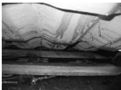
Fot. 1. Dach z zatkanymi wlotami w okapie i na kalenicy po roku eksploatacji. MWK przepuszcza wilgoć z wnętrza dachu, która pozostaje pod blachodachówką i skraplając się, zawilgacałaty i kontrłaty
