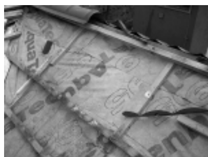
Fot. 16. Ten dach też ma ok. 4 lat, a laty są w dużo gorszym stanie. Wymagaly wymiany w trzech rzędach. Na podstawie takich odkrywek stwierdzono, że zawilgoczone laty (bez wentylacji) wytrzymują maks. 3–5 lat
