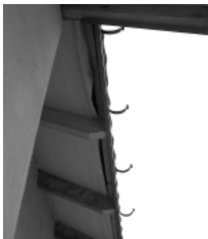
Fot. 12. Typowy wadliwy okap. Nierówności więzby powodują, że źle zamontowana MWK raz tworzy kieszeń, a raz spada w dół. Woda ściekająca po membranie będzie więc zawsze nie tam, gdzie powinna być (poza okapem, a nie w nim)
