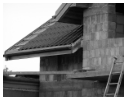
Fot. 10. Lewa część tego samego dachu w budowie jak na fotografii 13. Wyraźnie widać, że nad MWK dostaje się tylko tyle powietrza, ile wynika z grubości haka rynnowego oraz powierzchni fali profilu. Ta łączna powierzchnia jest o połowę za mała
