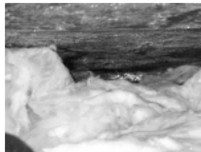
Fot. 5. Skutki braku wentylacji pokrycia: wierzchniej warstwie termoizolacji tuż pod MWK zgromadziły się duże ilości skroplin w formie szronu, co spowodowało zalanie pomieszczeń po włączeniu ogrzewania
