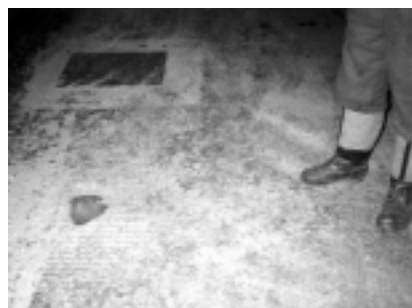
Fot. 1. Zniszczona podłoga betonowa w chłodni
