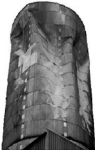
Fot. 1. Silos uszkodzony w wyniku działania podciśnienia (Fot. T. Heizig)
