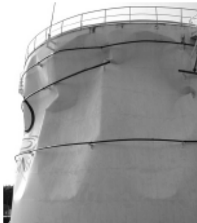
Fot. 2. Zbiornik uszkodzony w wyniku działania podciśnienia (Fot. J. Ziółko)
