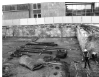
Fot. 5. Zabezpieczenie wykopu kolumnami CSM w przypadku budowy Małopolskiego Centrum Biotechnologii UJ w Krakowie
