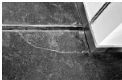
Fot. 2. Uszkodzenie narożnika płyty (Fot. B. Meronk)
