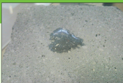
Powierzchnia betonowa niezabezpieczona środkiem hydrofobizującym
