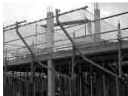
Fot. 4. Siatka zabezpieczająca SARE
