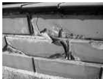
Fot. 2. Zaprawa cementowa jest zbyt sztywna, aby pełnić rolę poduszki. Nie kompensuje naprężeń termicznych, lecz je powiększa
