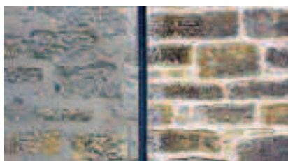
Fot. 3. W niektórych przypadkach zaprawa wapienna jest niezastąpiona; po lewej fragment historycznej elewacji z piaskowca po konserwacji zaprawą cementową, po prawej fragment tej samej elewacji po użyciu tradycyjnej zaprawy wapiennej
