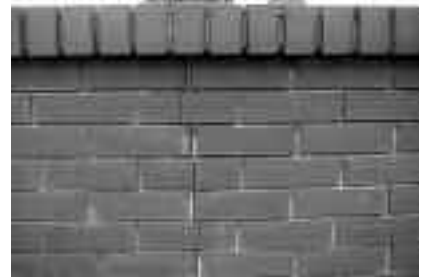
Fot. 1. Samozdylatowanie się muru z klinkieru
