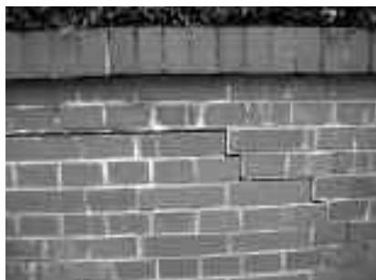
Fot. 3. Pęknięcie i oberwanie muru w wyniku błędów fundamentowania
