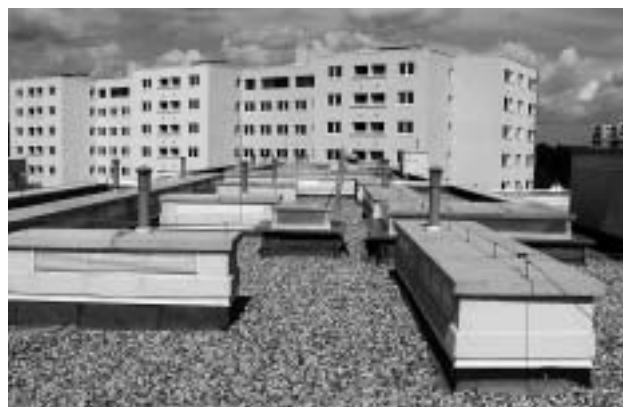
Fot. 3. Niezgodna z przepisami obudowa wylotów przewodów wentylacyjnych
