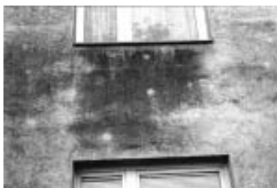
Fot. 7. Glony na fasadzie budynku
