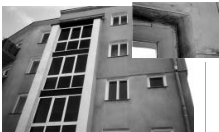
Fot. 1. Nowy budynek wielorodzinny w Ostrowi Mazowieckiej; widoczna pleśń jest wynikiem występowania mostków termicznych powstałych w wyniku błędów w projekcie
