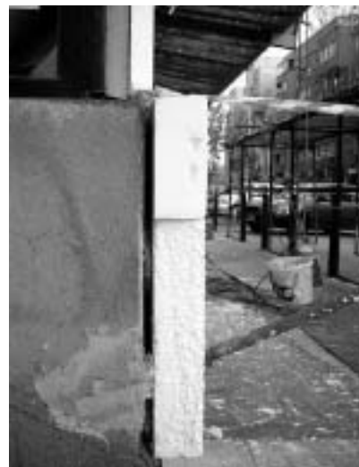
Fot. 2. Niewłaściwe przyklejanie płyt ze styropianu
