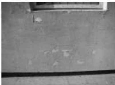
Fot. 5. Łuszczący się tynk
