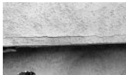
Fot. 8. Pęknięcie strefy cokołowej
