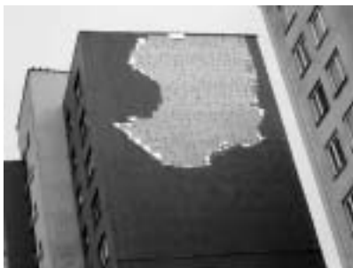
Fot. 1. Niewłaściwe przygotowanie podłoża
