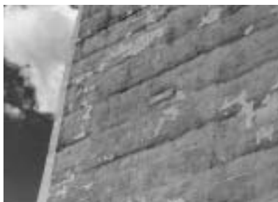
Fot. 6. Wyoblenie i odspojenie tynku
