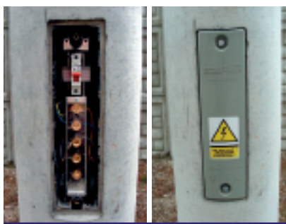
Fot. 2. Skrzynka bezpiecznikowo-złączeniowa w słupach EOP
