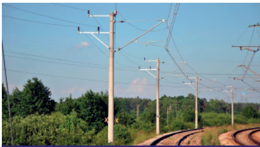
Fot. 3. Słupy ETG na łuku linii kolejowej
