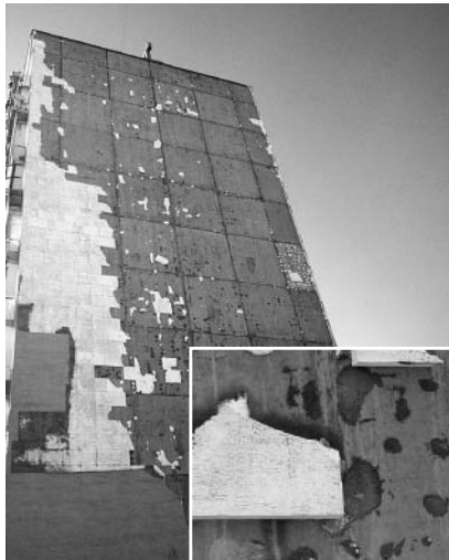
Fot. 2. Przykład efektu stosowania tanich, „uniwersalnych” zapraw klejących o niskiej przyczepności do podłoża + niewłaściwy montaż
