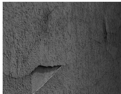
Fot. 1. Uszkodzenia wynikające z braku kompatybilności (w tym przypadku brak adhezji pomiędzy składnikami systemu)
