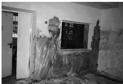
Fot. 2. Widok osłony z folii PCW zamontowanej na wewnętrznej powierzchni ściany w celu zwiększenia suszenia muru metodą absorpcyjną
