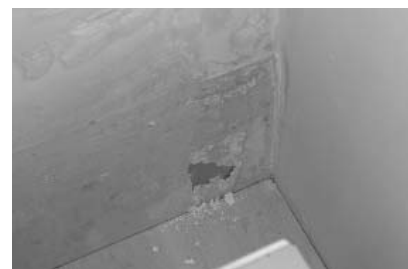
Fot. 3. Przykładowy widok „wysoleń” na powierzchni tynku powstałych w wyniku zalania mieszkania wodą wyciekającą z instalacji c.o.
