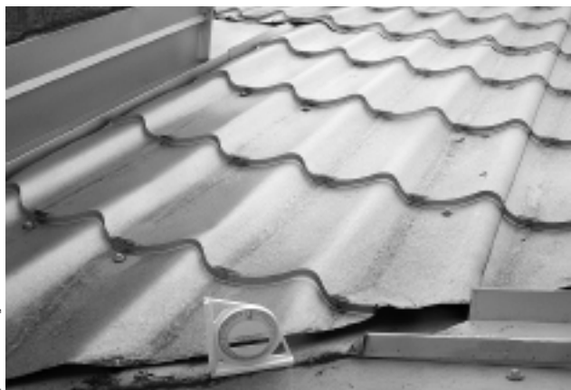
Fot. 1. W przypadku gdy kąt nachylenia dachu wynosi 14°, w zlewni kosza linia splywu wody ma nachylenie 9°. To powoduje łatwe podwiewanie opadów i zatrzymywanie się wody pośniegowej, która często dostaje się pod pokrycie
