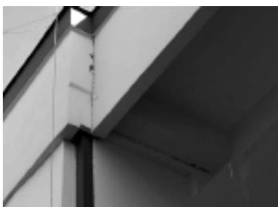
Fot. 3. Zarysowania w dylatacjach Photo 3. Cracks in expansion joints
