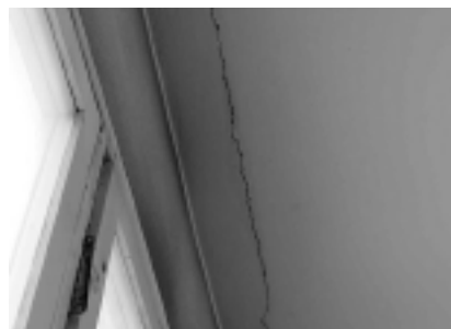
Fot. 2. Zarysowania wzdłuż styku płyt stropowych i nadproży Photo 2. Cracks along interface between slab plates and window lintel
