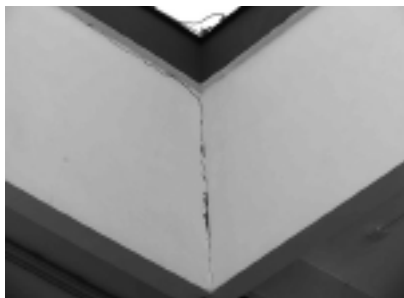
Fot. 4. Zarysowania wzdłuż styku płyt osłonowych Photo 4. Cracks along interface between curtain walls
