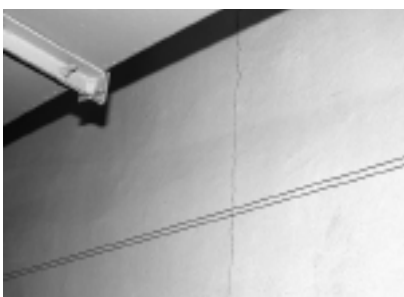
Fot. 5. Zarysowania betonowych ścian piwnic Photo 5. Cracks in RC walls in basement
