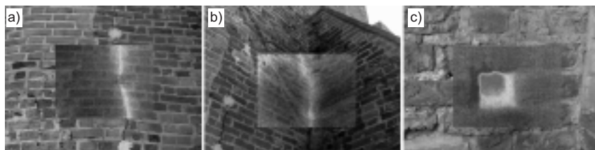
Fot. 3. Dokumentacja termowizyjna muru: a) pęknięcie konstrukcyjne; b); c) miejsca intensywnie występującej wilgoci
