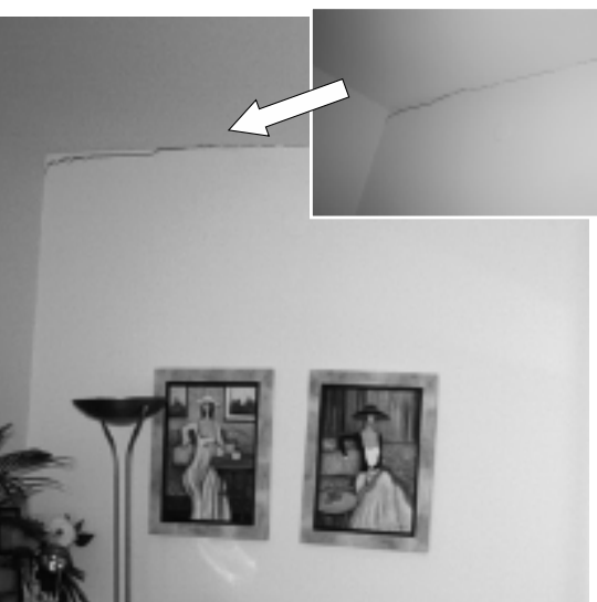
Fot. 2. Zarysowanie na styku ściany i sufitu [Fot. L. Misiewicz] Photo. 2. Cracking at the junction of wall and ceiling
