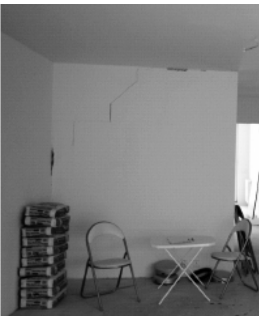
Fot. 1. Zarysowania ścian przed oddaniem obiektu do użytkowania [Fot. L. Misiewicz] Photo. 1. Cracking of walls before building into use
