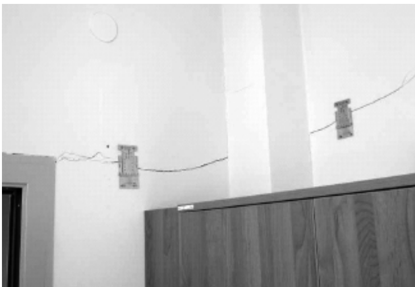
Fot. 3. Widok mierników rys zabudowanych na zarysowanych ścianach wypełniających [Fot. Ł. Drobiec] Photo. 3. View of the crack measures mounted on the walls
