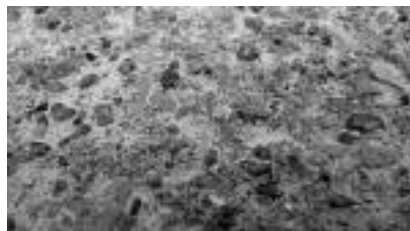
Fot. 1. Wymyta z zaprawy powierzchnia stwardniałego betonu
