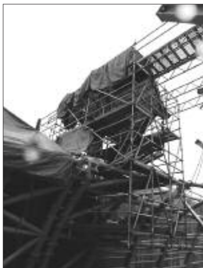
Fot. 2. Rusztowanie wykorzystywane do prac malarskich podczas budowy Muzeum Historii Żydów Polskich w Warszawie, 2010
